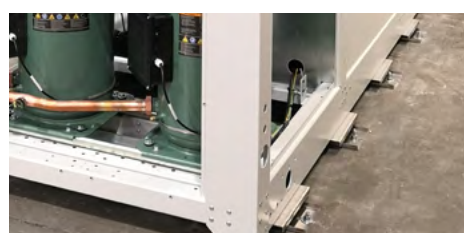
Chiller impianto di climatizzazione
